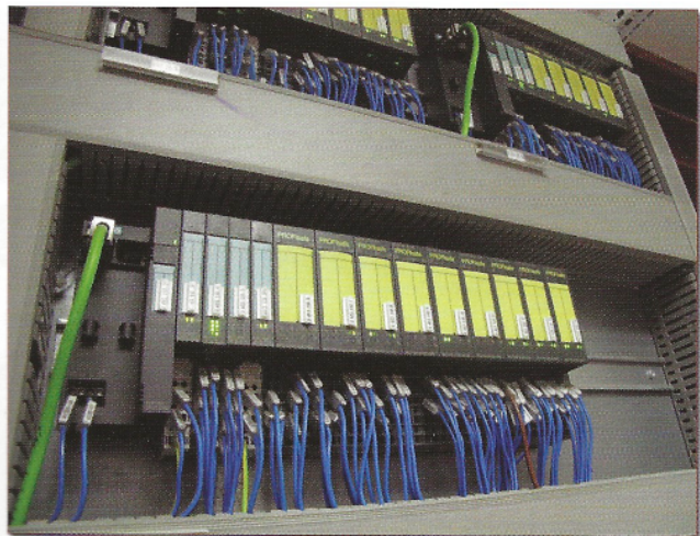
Le traitement de la sécurité passe aussi sur réseau Profinet.
